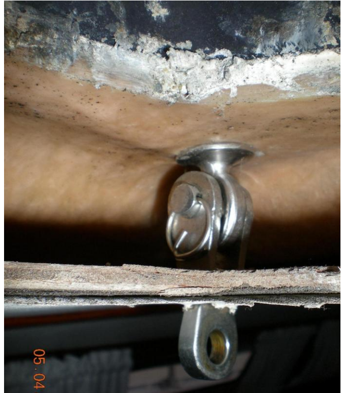
Her ses øjebolten og togglen gennem loftbeklædningen.
